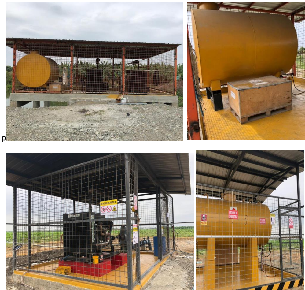
Fuente: Visita técnica, 2021.
