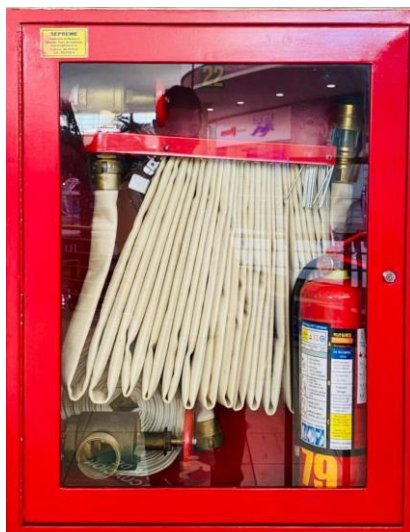
Imagen 3.16 Gabinete contra incendios (BIE Clase III)
