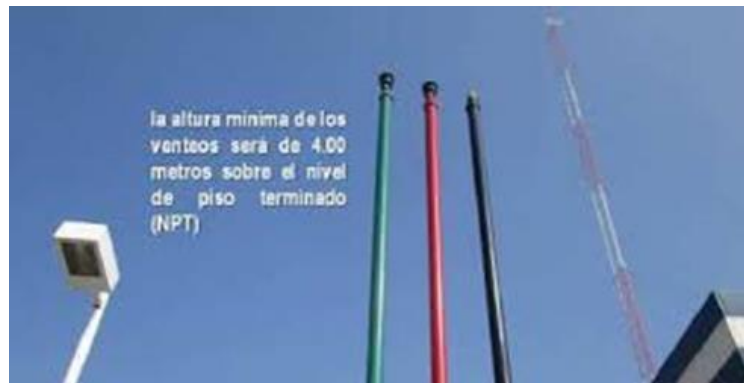
Gráfico 83: Red de Ventilación, estación de servicios "COOPERATIVA DE TRANSPORTES PASCUALES".
