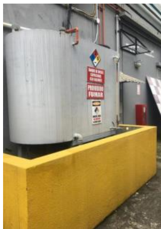
Figura 7. Tanque reservorio de diésel
