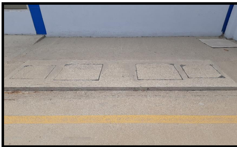
Trampa de grasa área Tecnicentro
