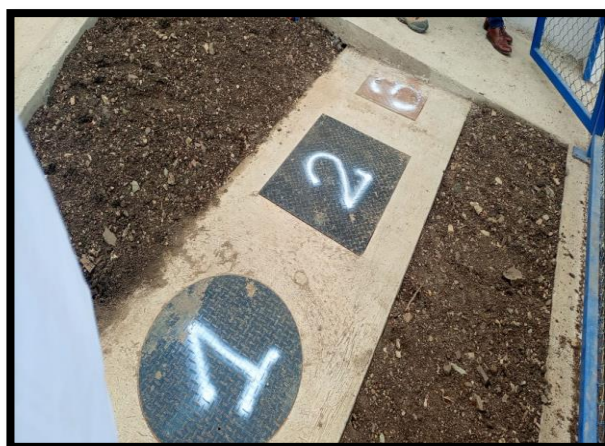
Trampa de grasas en el área de despacho de combustible
