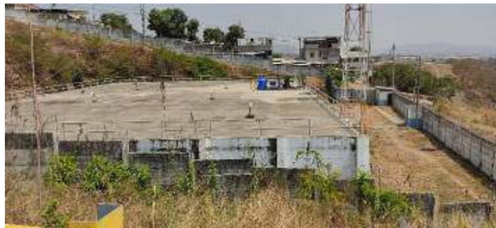
Fotografía 73 Tanque de Reserva Flor de Bastión 1
