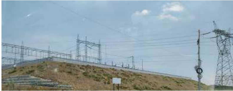
Fotografía 50. Subestación Eléctrica existente en el tramo del 5to acueducto
