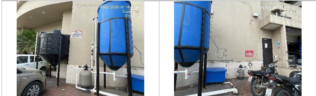
Figura 2-8. Infraestructura del STAR
