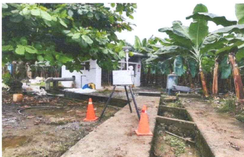
Ilustración 17 Equipo instalado para mediciones de calidad de aire y material particulado estación de bombeo 1 (riego subfoliar).
