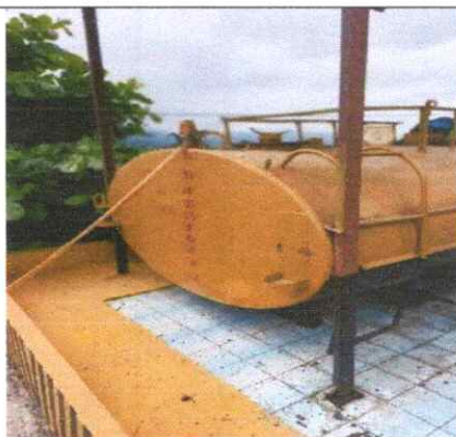
Tanque de almacenamiento de combustible, con su cubeto antiderrames.
