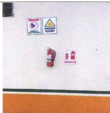
Extintor y señalética
