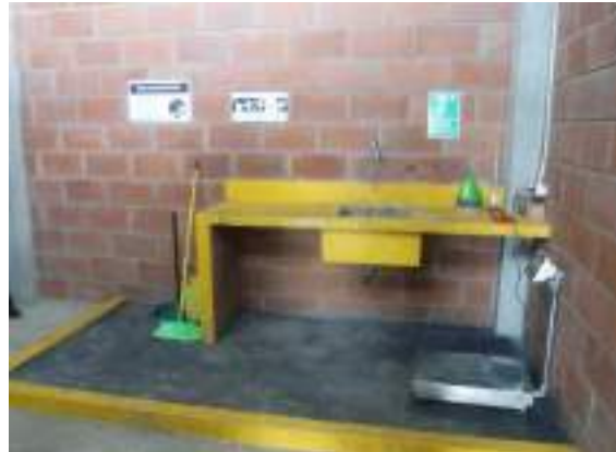
Fotografía 1-48. Lavaojos y unidades de señalética instalada en la bodega de agroquímicos de la Hacienda Bananera Benjamín alusiva a medidas de información.
