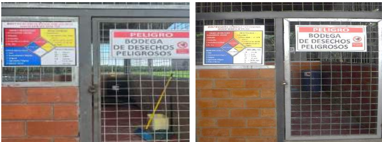
Fotografía 1-61. Áreas de almacenamiento temporal de desechos peligrosos con sus correspondientes señaléticas de identificación e información, cerramiento perimetral que impide el acceso de animales o personal no autorizado, techado, iluminación y ventilación, piso impermeabilizado, kits antiderrames, entre otras especificaciones contenidas en la norma técnica vigente aplicable.
