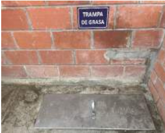
Fotografía 1-65. Trampa de grasa
