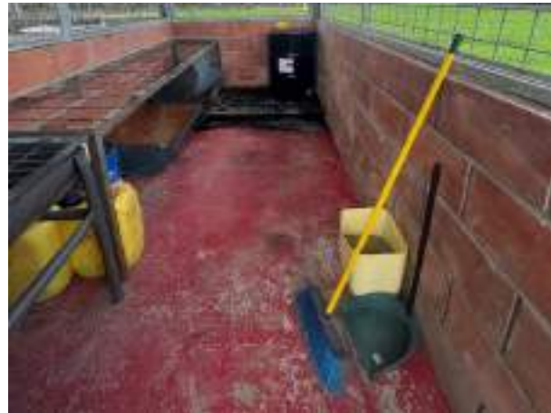
Fotografía 1-63. Características/particularidades de las áreas de almacenamiento temporal de desechos peligrosos (kit antiderrame, piso impermeabilizado, estructuras para filtros, entre otras).
