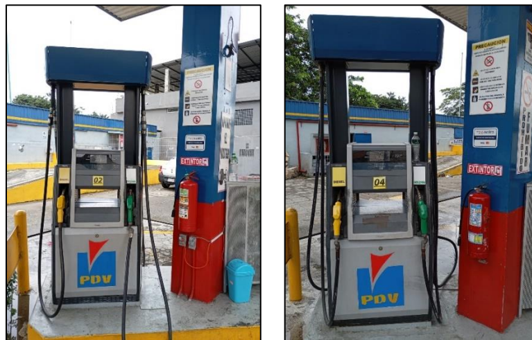
Ilustración 5. Dispensadores de combustibles
