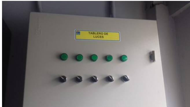
Ilustración 16. Tablero de distribución de energía eléctrica
