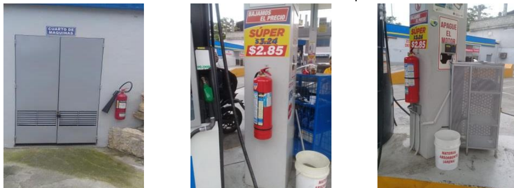
Ilustración 14. Extintores contra incendio portátiles
