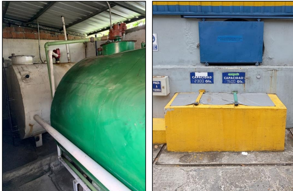
Ilustración 7. Área de tanques de combustible de la Estación de Servicio
