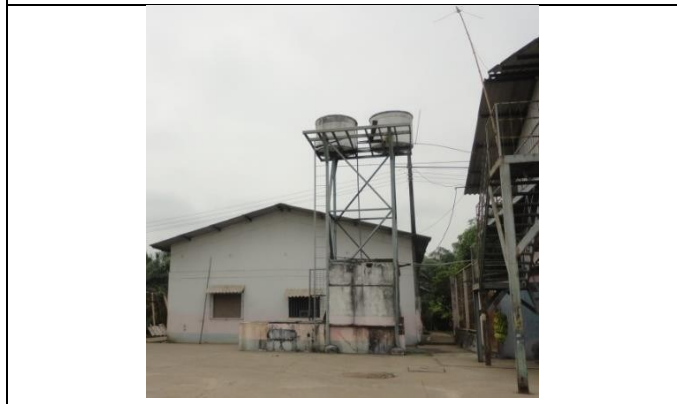
Figura 21: Cisterna para almacenamiento de agua subterránea
