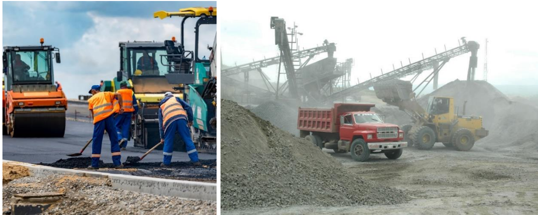
Figura 6. Equipos de ABRECABUYA.
