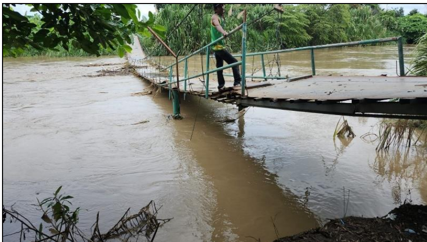
Figura 2. Acumulación de palizada, ocasionada por la creciente del rio chimbo.
