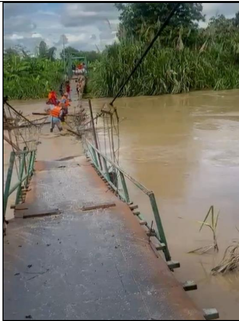
Figura 3. Colapso de los tableros peatonales de la Estructura.
