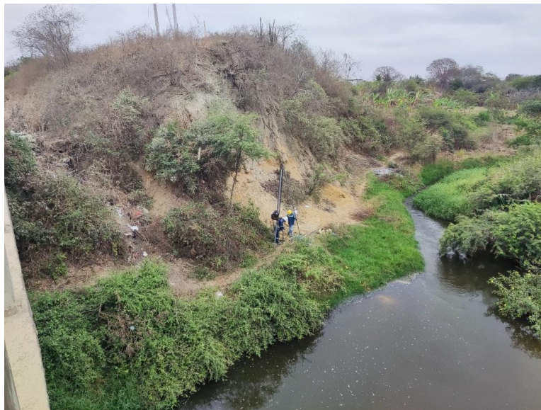
Perforaciones en Puente San Miguel
