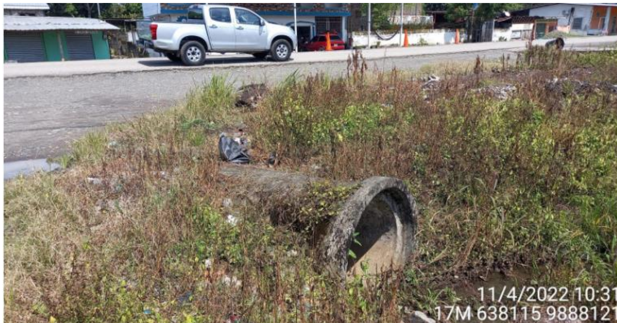
Figura 3: Estado de la alcantarilla, abscisa 3+945.
