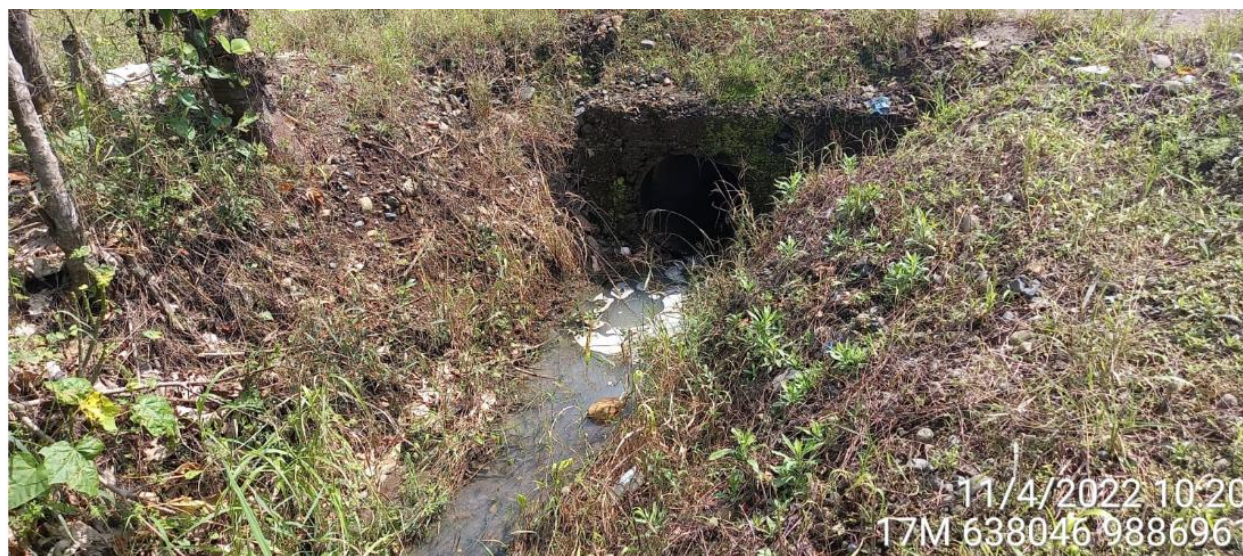
Figura 13: Estado de ductos existentes.
