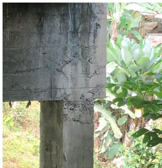
Ilustración 6. Segregación en viga cabezal y columna de pila de puente.
