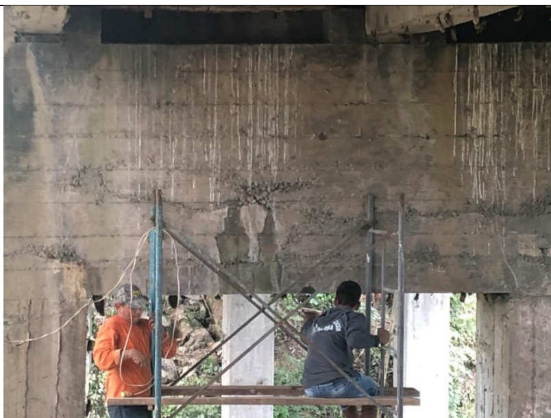
Ilustración A7. Se observa segregación en la zona central de la viga cabezal C1.
