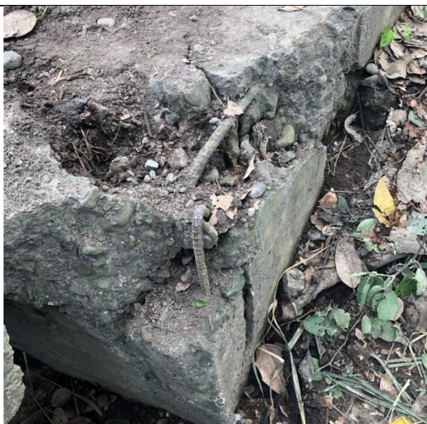
Ilustración A10. Varillas expuestas de la unión losa de aproximación y estribo
