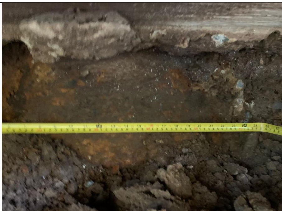
Ilustración A11. Camisa de pilote encontrado bajo la zapata pila izquierda
