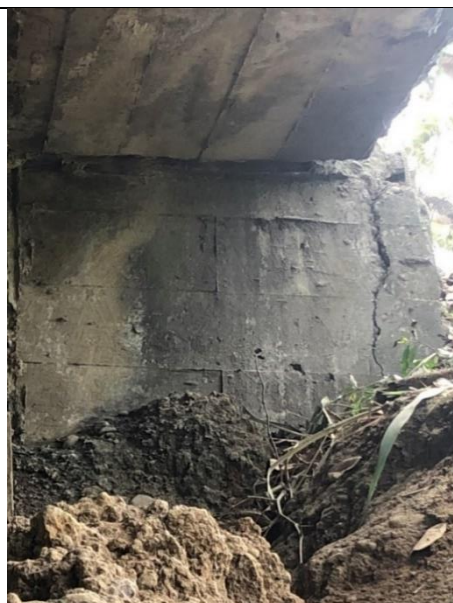
Ilustración A11. Grieta del hormigón en el estribo derecho
