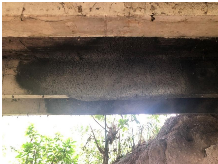
Ilustración 7. Viga de 0.85 m presenta evidencias de hollín y grout de reparación.
