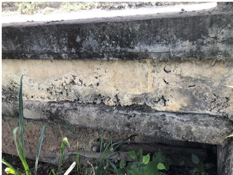
Ilustración 9. Segregación en las barandas del puente.
