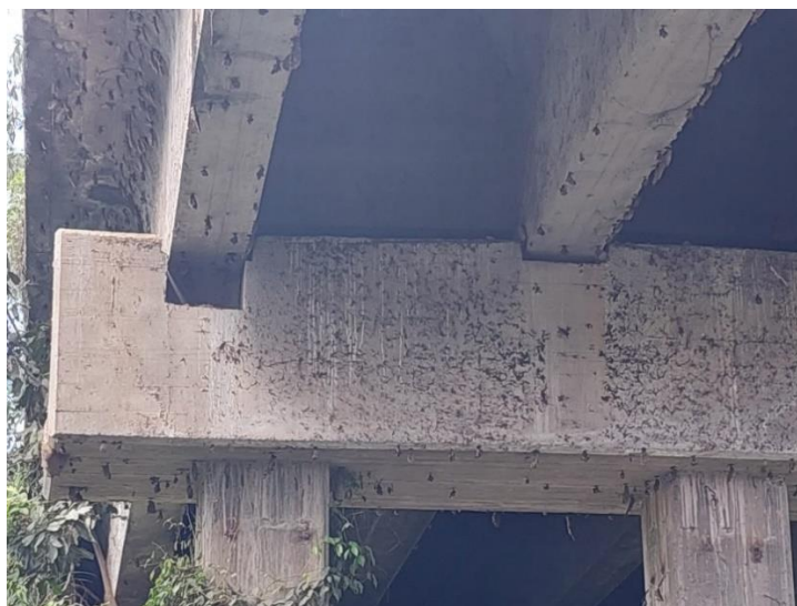
Ilustración 8. Estado de la viga y pila en la abscisa 1+121.70
