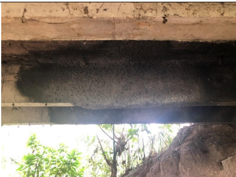
Ilustración A9. En dos de las vigas se identifica una lechada de concreto.
