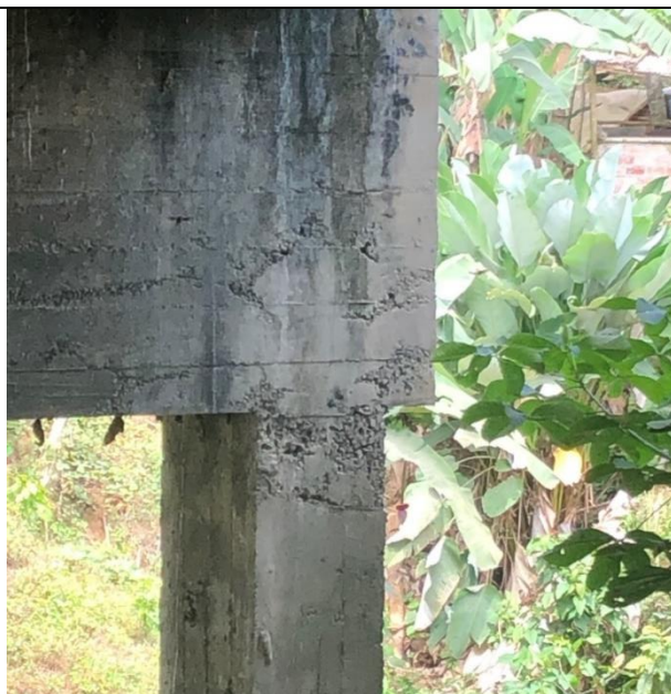
Ilustración A8. Parte de la columna que soporta la viga cabezal C1 presenta segregación en su parte superior.
