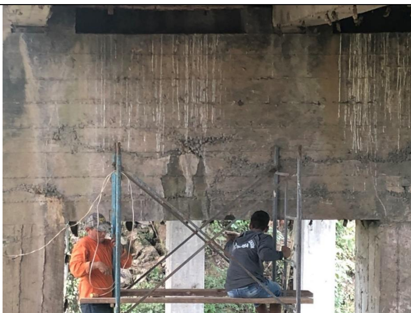
Ilustración A7. Se observa segregación en la zona central de la viga cabezal C1.
