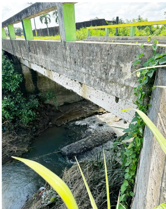
Figura 6. Levantamiento de daños en la subestructura y superestructura del puente
