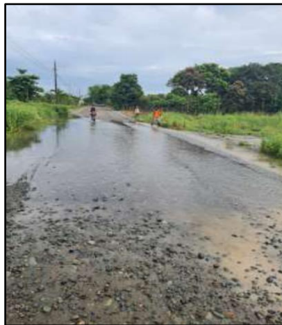
Figura 4. Puente sobre el Estero Hediondo inundado.
