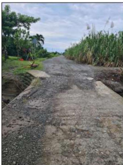
Figura 6. Puente sobre el Estero Toro, Estructura en malas condiciones.
