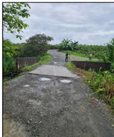
Figura 5. Puente sobre el Estero Hediondo, Estructura en malas condiciones.
