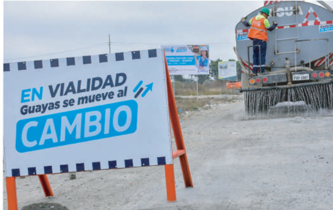
Cada día, por la avenida Tanasa circulan alrededor de 500 vehículos. Every day, around 500 vehicles circulate along Tanasa Avenue.
