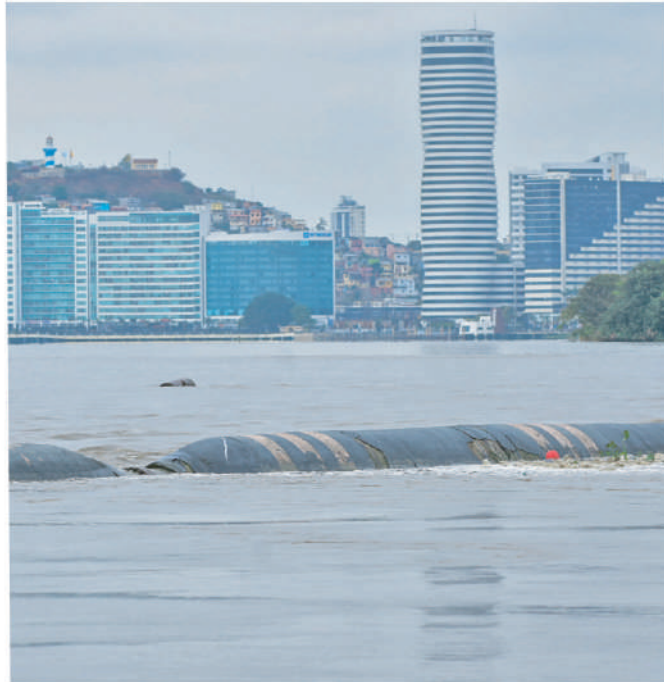
Vista de una sección de la tubería que extrae sedimento de los alrededores del islote El Palmar. View of a section of the pipeline that extracts sediment from around El Palmar islet.
