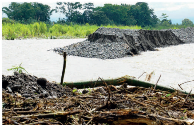
El fuerte invierno afectó las obras de infraestructura, incluso los trabajos de prevención. The strong winter affected infrastructure works, including prevention works.
